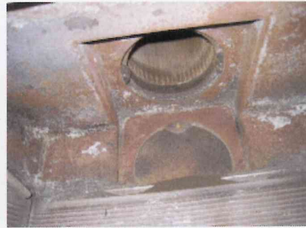
♪ストーブ内部煙突部分
